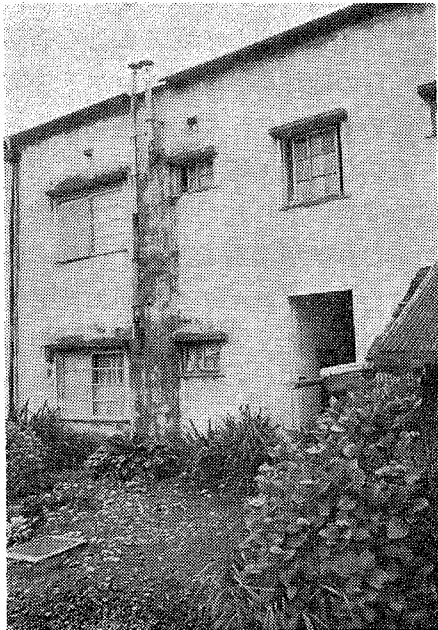
写真-16 雨水が壁面からしみ込んだ跡(9棟)
