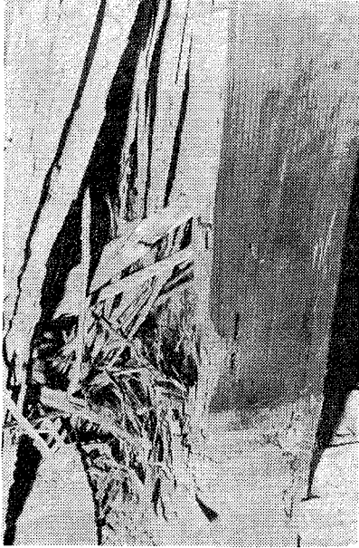
写真1 被害例(柱脚部)
