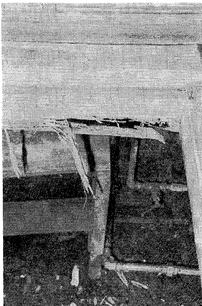
写真5 被害例 (保温帯不良)
