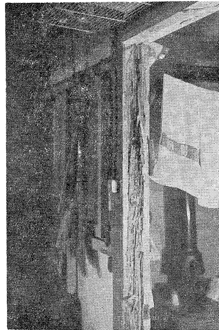
写真-3 天井の高さまで内部をひどく食害された浴室入口の柱 (9棟7号宿舎)
