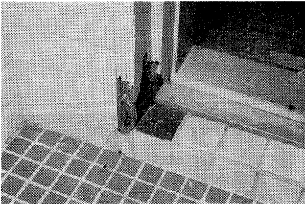
写真4 被害例（浴室出入口敷居）
