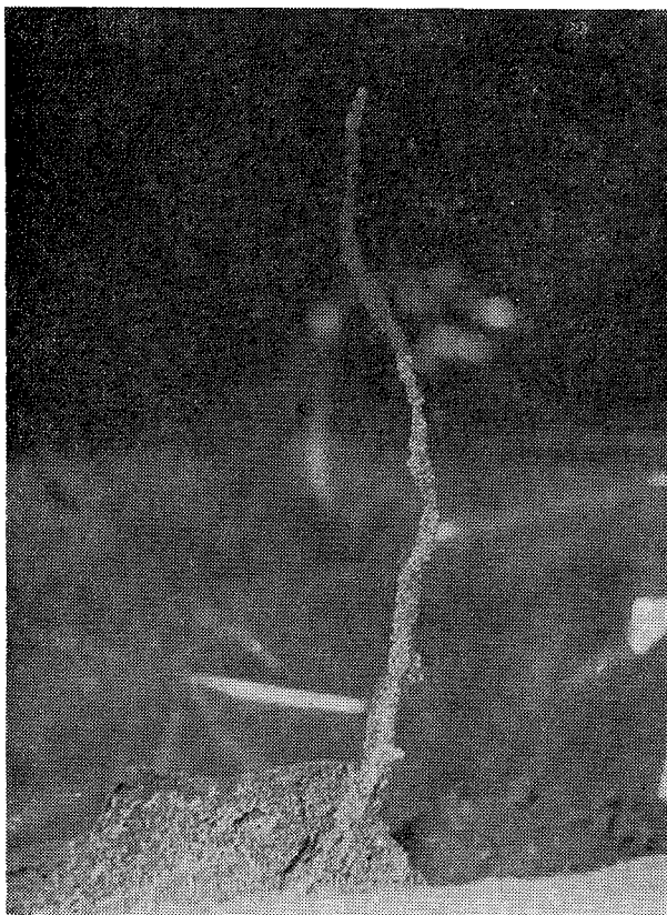
写真一1 空中に突出してつくられたイエシロアリの蟻道 (高さ約25cm)
