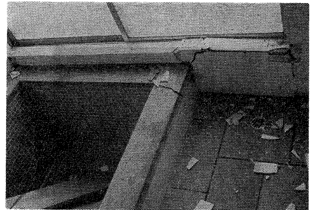
写真28 風呂場のタイルの破損 (東子浦地区)
