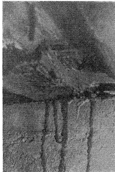
写真10 上昇蟻道と被害
