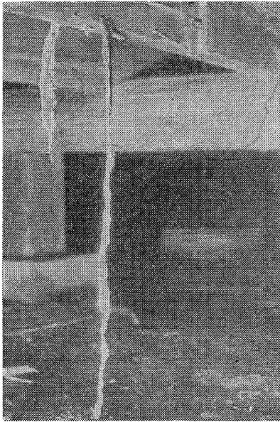
写真27 カンモンシロアリの 空中蟻道(1)
