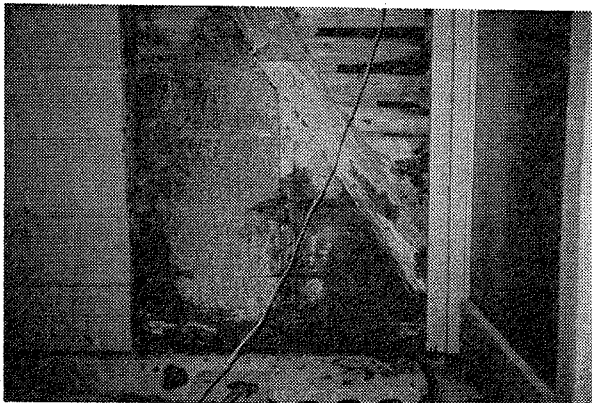
写真14 出入口の庇が小さく雨仕舞の悪さが雨の際に被害部分ドア側から雨水がしみ込んでいた。
