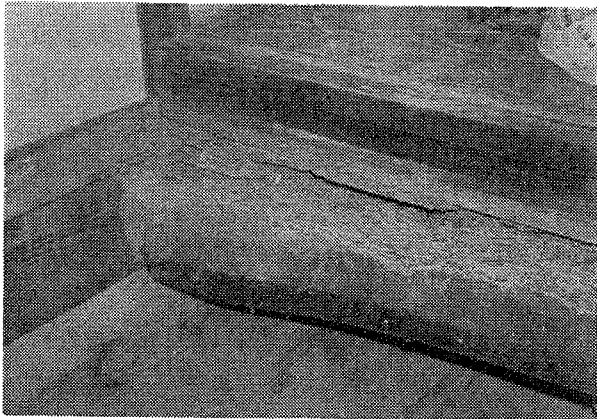
写真2 小屋組材の内部に巣をつくっている場合の土砂の附着状況
