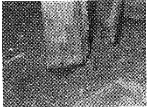
写真10 束柱のヤマトシロアリによる被害（束石は充分に土砂に埋まり、束柱下部はシロアリ被害とともに腐朽している。）
