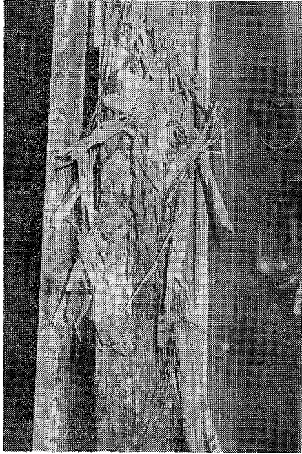
2-14写真 シロアリ被害
