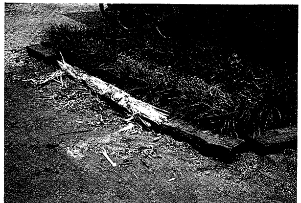
第8図 花壇の土留材として利用された古まくらぎのシロアリ被害
