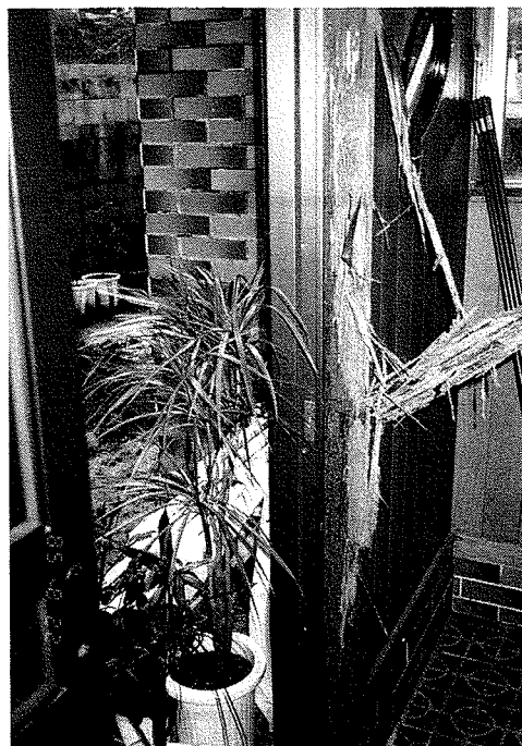
写真—17 玄関化粧材の被害
