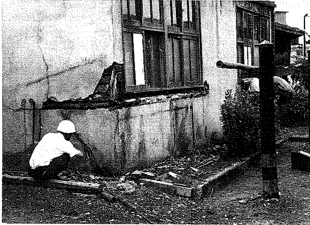
第2図 モルタル壁内部のイエシロアリによる被害 (柱下部は完全に食いつくされて浮いている)
