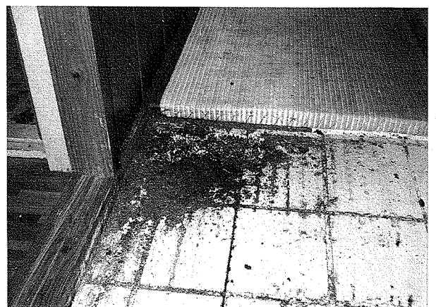
写真六 発泡スチロール床の被害
