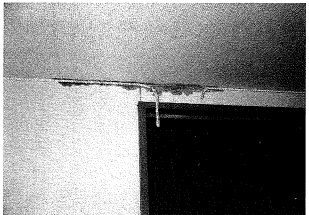
写真—16 布製壁材の被害
