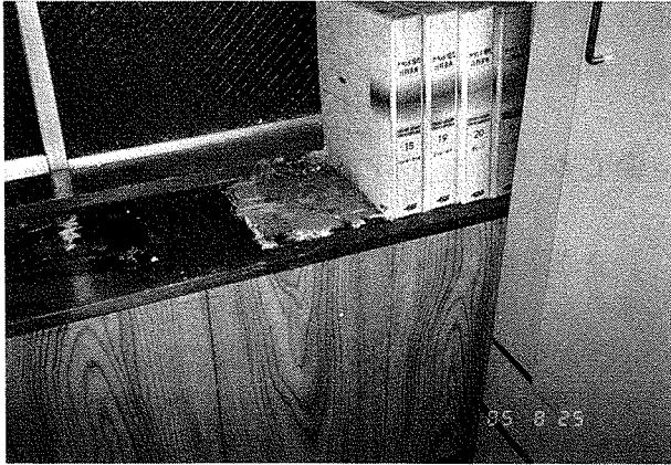
写真—13 窓に置いた書物の被害
