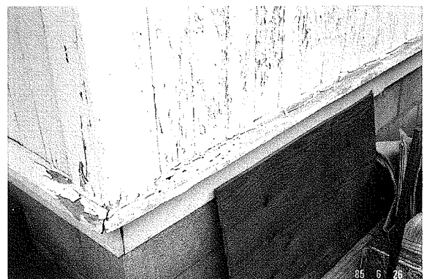
写真—11 木造建物における乾材シロアリの被害
