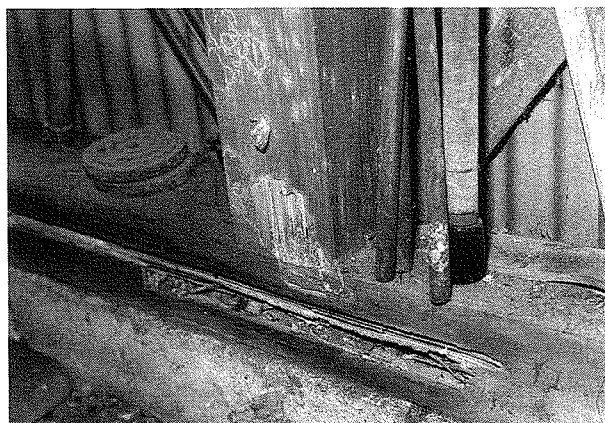
写真 7 イエシロアリによる土台の被害(A家の物置小屋)
