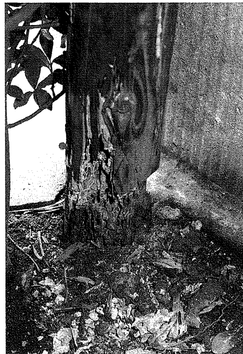
写真10 イエシロアリによる柵の木柱の被害(A家の北西隅)
