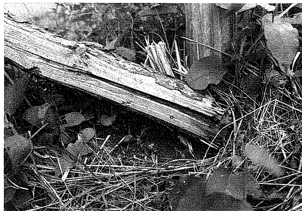
写真3 写真1の手前左側の柵の木材（木材内部はイエシロアリにかなりひどく食害されていた）
