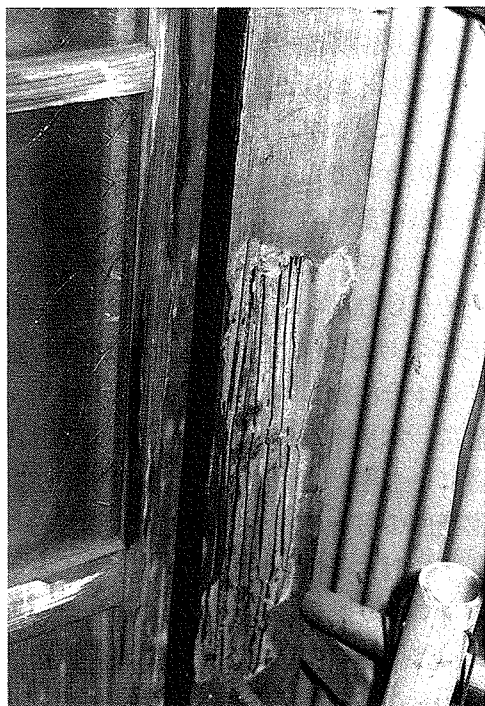
写真 8 イエシロアリのよる柱の被害(A家の物置小屋)
