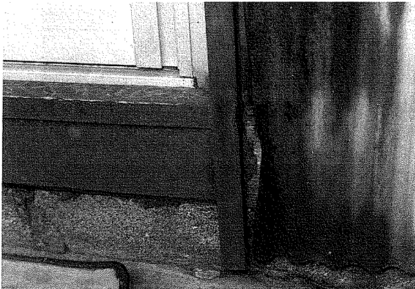
写真11 土台の下と柱の横に構築されたイエシロアリの蟻道(土)(C家の物置小屋)
