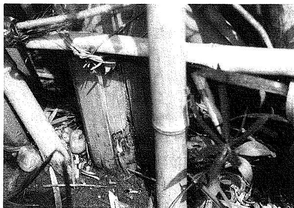
写真4 イエシロアリに加害された柵の木柱（空地の北東隅の木柱）
