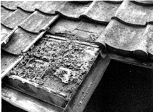
被害部門 1位 橋本 智 「野地板の被害」
