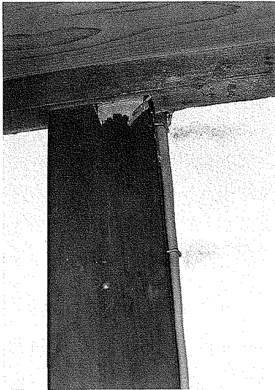
写真13 1階和室（6畳）の柱上部のアメリカカンザイシロアリによる被害
