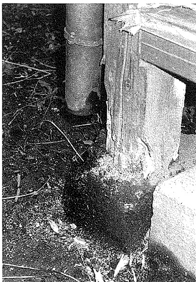
写真3 調査建物の南向かいの建物における柱のヤマトシロアリと腐朽の被害
