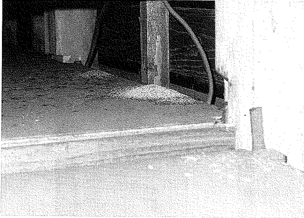
写真17 2階天井裏に堆積していたアメリカカンザイシロアリの糞
