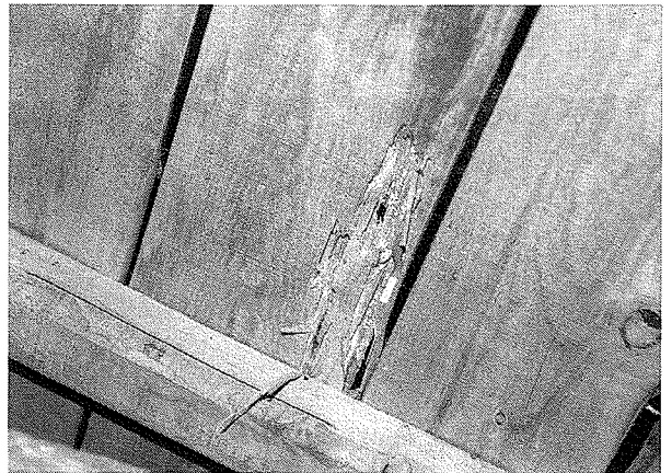
写真12 1階和室(6畳)におけるアメリカカンザイシロアリによる野地板の被害
