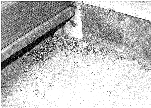
写真2 調査建物の南向かいの建物玄関外部に排出されたアメリカカンザイシロアリの糞
