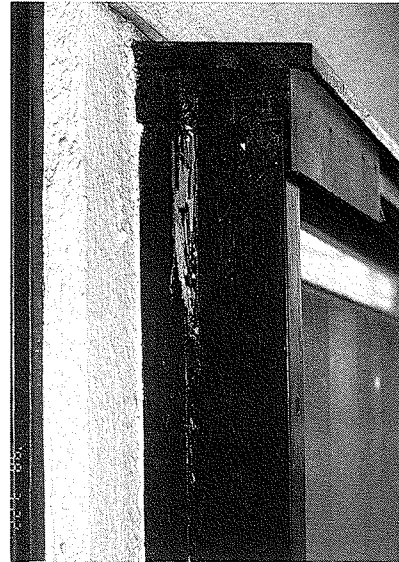
写真15 1階和室（6畳）の窓枠のアメリカカンザイシロアリの被害
