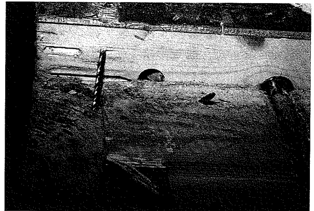
写真 3 2 階床コーナー内部の食害状況。胴差の端面（写真左手）およびその周囲に発達した蟻道が見られる。
