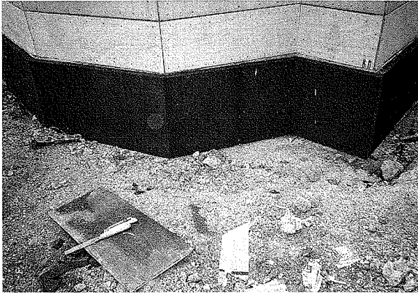
写真12 無機質（ガラス）発泡断熱を使用した外断熱基礎
