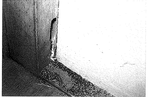
写真8 柱の被害と虫糞
