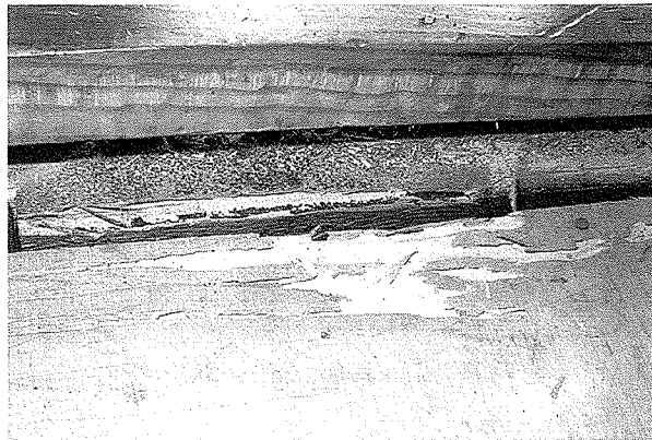
写真2 写真1の床板部分の被害
