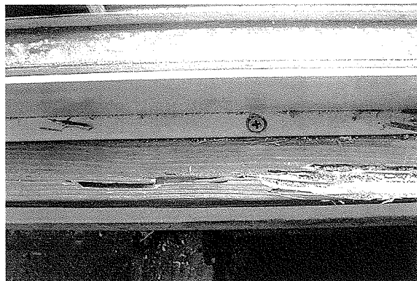
写真4 2階室内, 窓枠の被害
