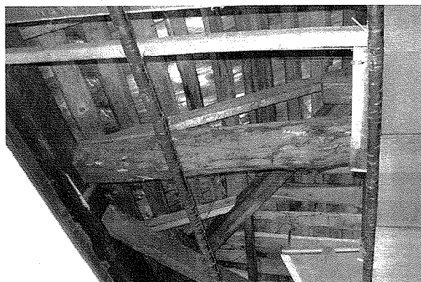
写真3 小屋組内部にも侵入
