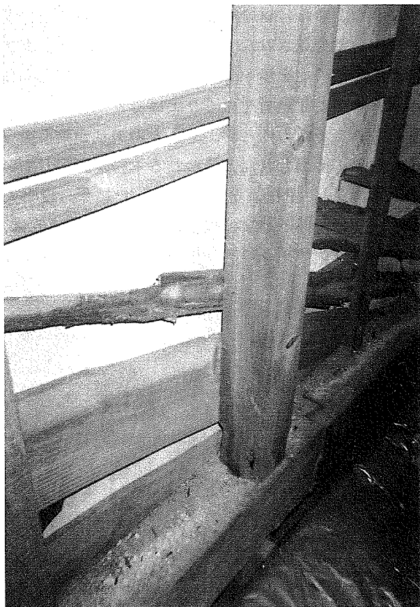
写真5 表面的には健全な屋根裏材
