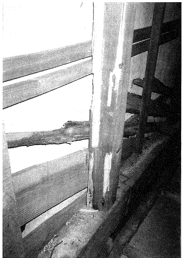
写真6 写真5の材における内部の被害
