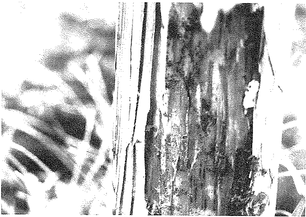
写真4 街路樹支柱のヤマトシロアリ 食害痕跡
