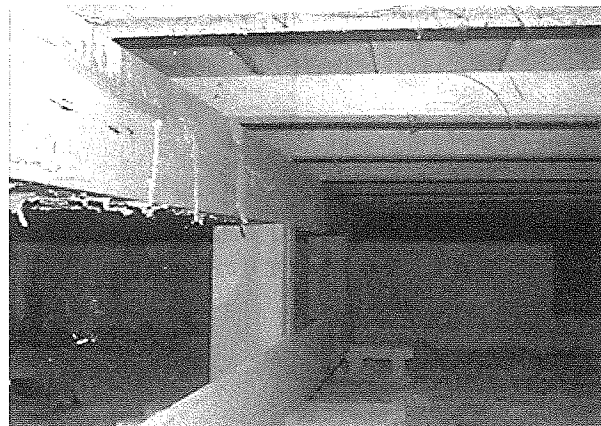
写真4 大引きの被害
