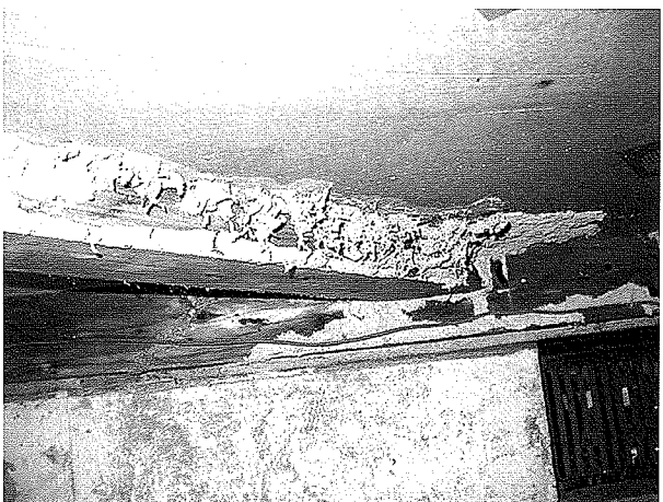
写真15 火打土台の蟻土崩落 (34日目)
