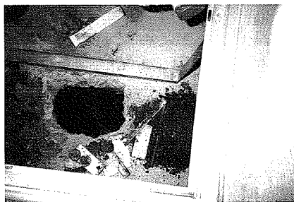
写真29 収納庫下のエサ木確認 喰害なし
