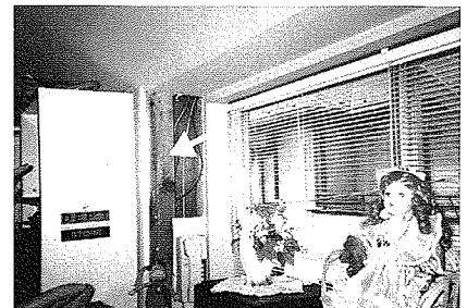
写真3 2階シロアリの喰害(柱) この柱から羽アリ発生
