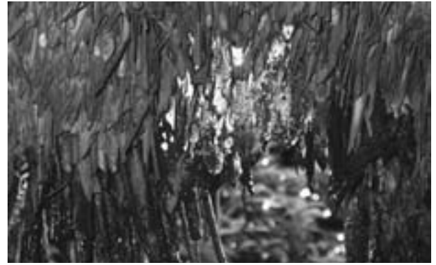
図7 旧池上家住宅北側軒先の様子。カビ繁茂による白色や黒色への変色
