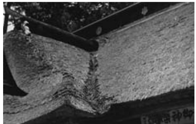
図17 曲がった構造の山形県熊野大社茅葺き屋根。雨水の流れが集中しがちな曲がり部分で生劣化が進行し易い。
