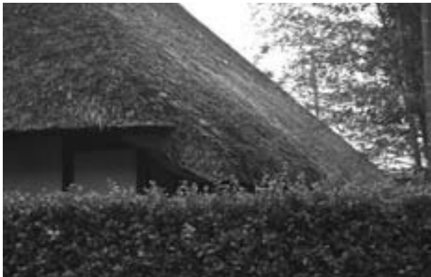
図6 旧池上家住宅北側の様子と屋根上での植物類繁茂
