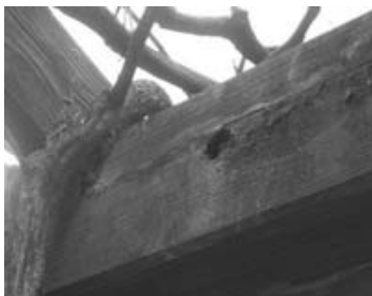
写真7 被害状況(フジ棚)
