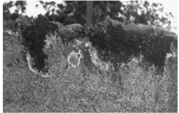
図16 伊勢神宮の諸社殿で軒下から見た際のV字型黒変部分
