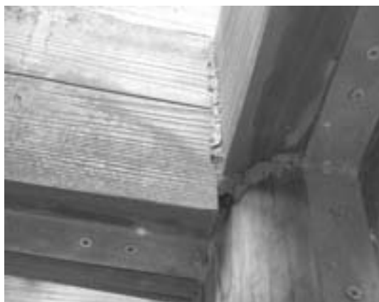
写真8 被害状況(フジ棚)
