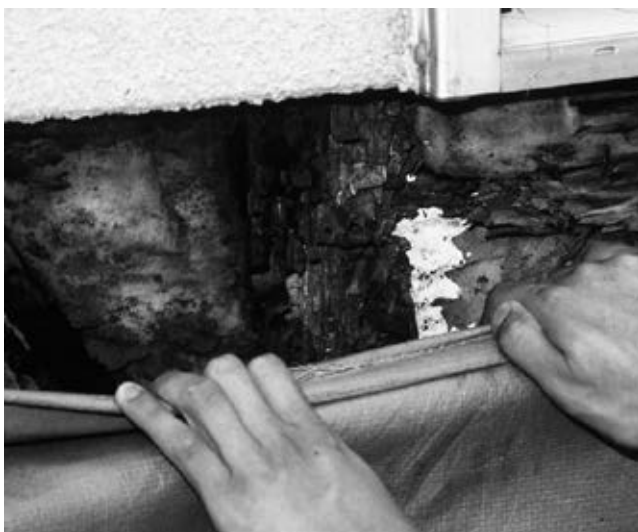
写真7 モルタル壁下地材の腐朽部分に営巣
