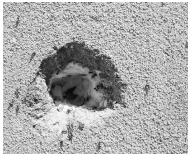
写真8 外基礎の断熱材に営巣 (ドライバーで掘削)
