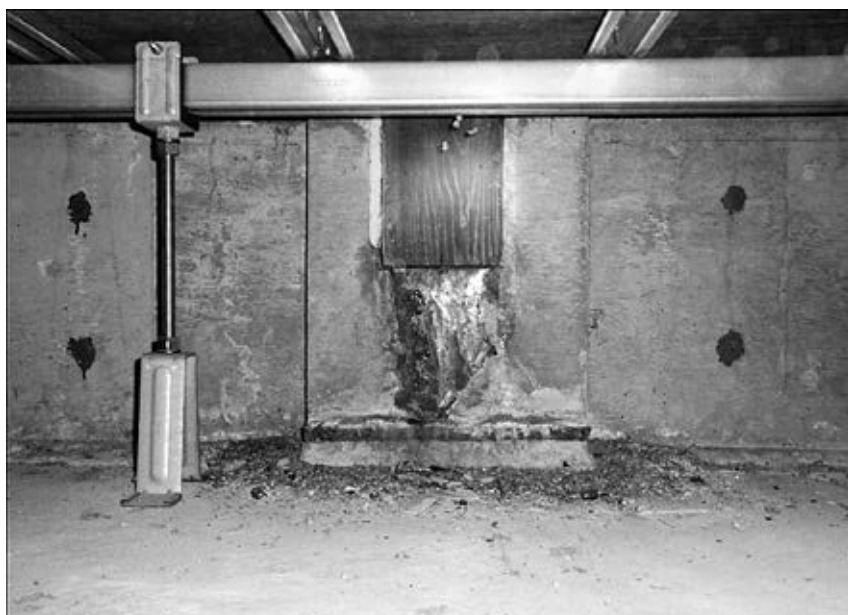
写真10 E2柱脚部の床下 (漏水により鉄柱が腐食)
