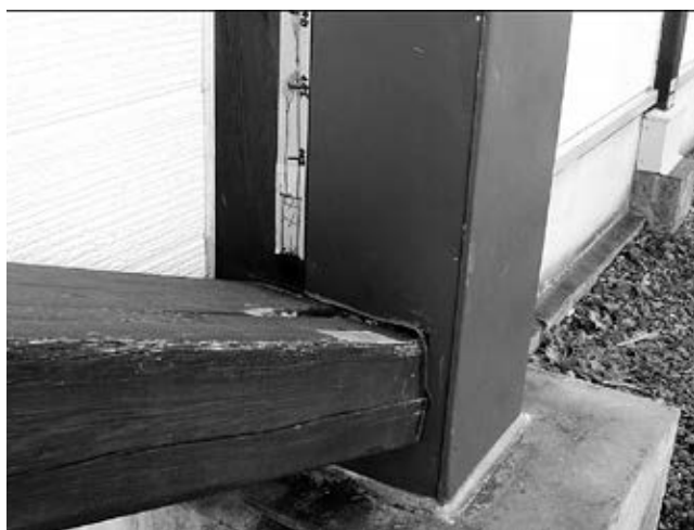
写真12 D1のメインフレームと筋交いの交差点部 (防水不良により雨水侵入)
