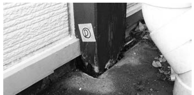
写真6 BC10.5の地際部（宙吊り状態）
