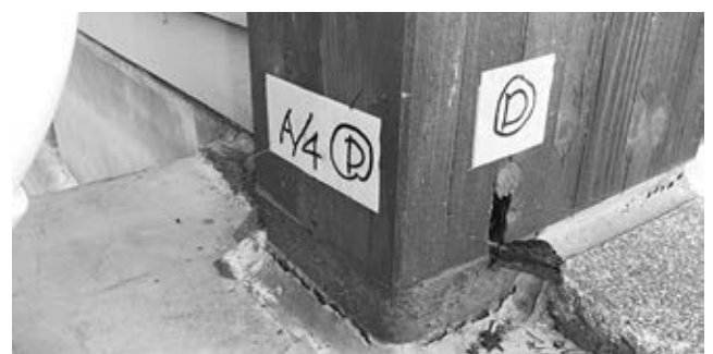
写真5 A4の柱脚部（局所的に劣化）
