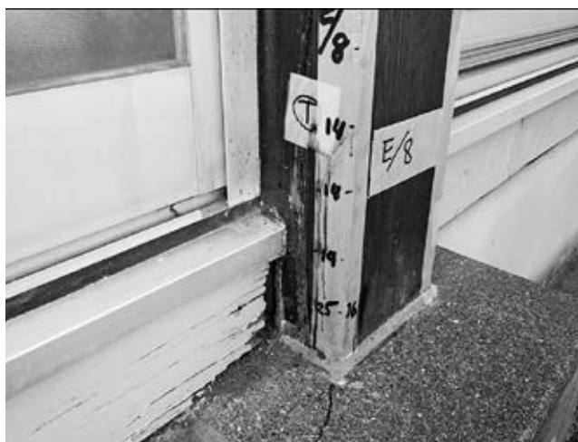
写真4 E8の柱脚部の腐朽と蟻害
