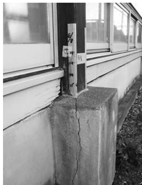
写真11 E8柱脚部の屋外 (コンクリートに亀裂)
