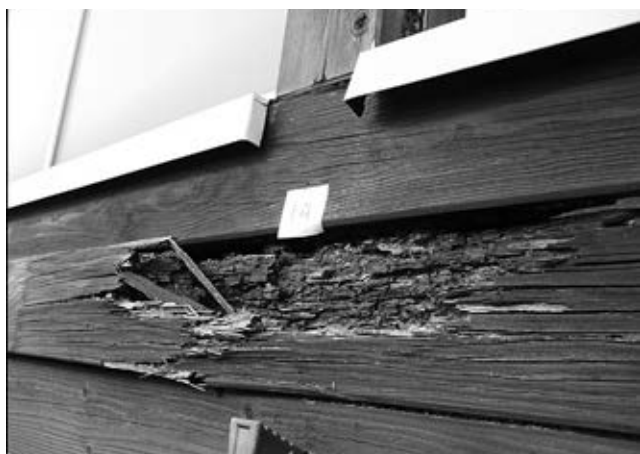
写真8 E8積層梁の劣化 (表層部の一部脱落)
