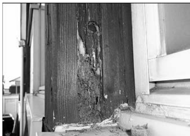
写真9 E8積層梁の上部にある管柱 (ここにも腐朽と蟻害が発生)
