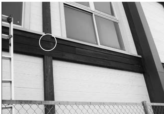
写真13 CD1積層梁の劣化位置 (○) (外見からは劣化が分からない)
