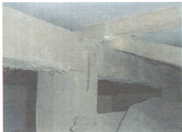
写真4 台所大引の蟻害
