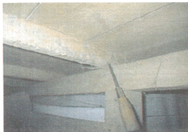
写真6 台所根下の蟻害
