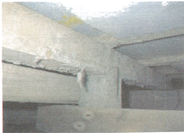
写真5 台所大引の蟻害
