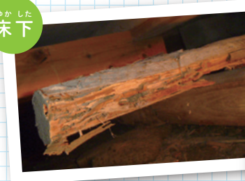
最も多い床下の被害
