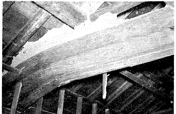
イエシロアリによる梁材の被害と分巢
