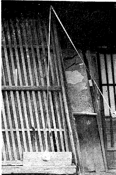
イエシロアリの食害による倒壊寸前の民家
