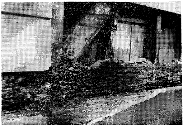
ヤマトシロアリの土台の食害
