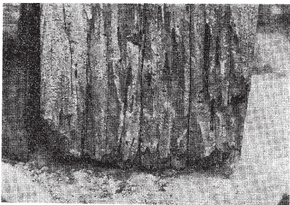
写真2 ダイコクシロアリの被害材(2)
