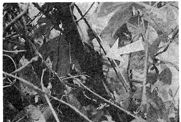
写真 7 PVCケーブルにクズの蔓が巻きつき、コウモリガのまゆがつくられており、ケーブルのこの部分が食害されていた
