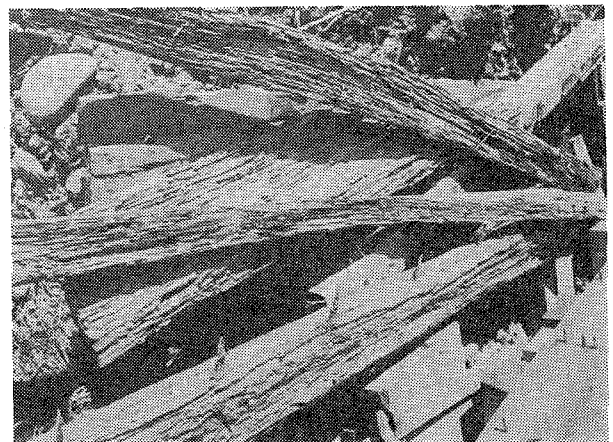
写真-1 ベニヒ板材の被害状況
