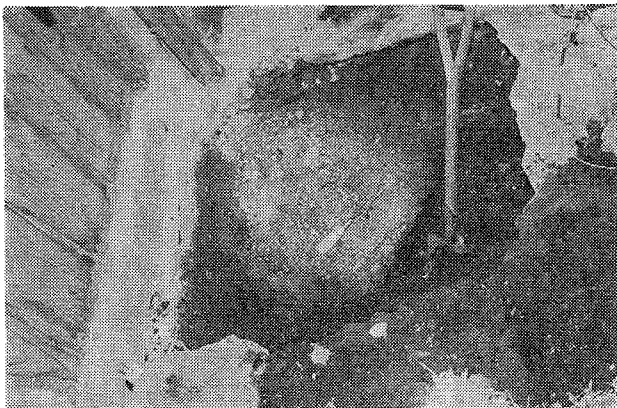
第17図 コンクリート床下の巣
