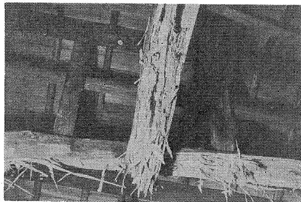
写真14 イエシロアリによる梁の被害(1)
