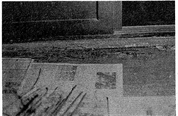
写真4 床板と敷居の蟻害
