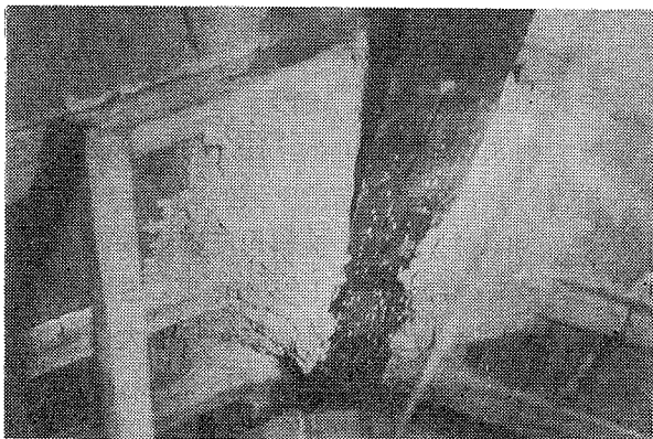
写真12 棟木につくられたイエシロアリの巣
