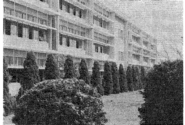
写真7 シロアリの被害を受けた校舎
