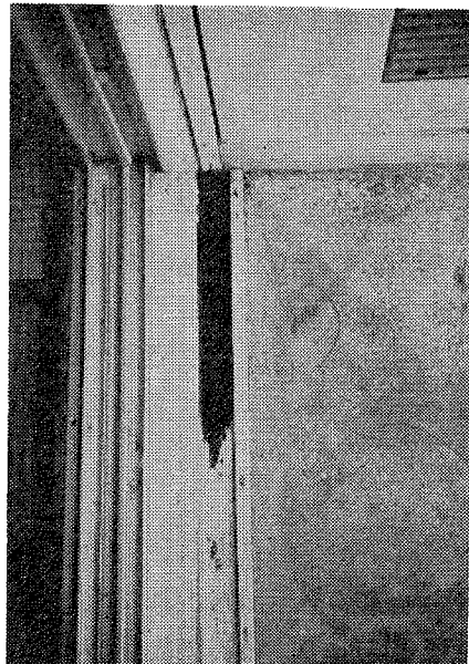
写真5 都営アパート5階の敷居に見る食害痕
