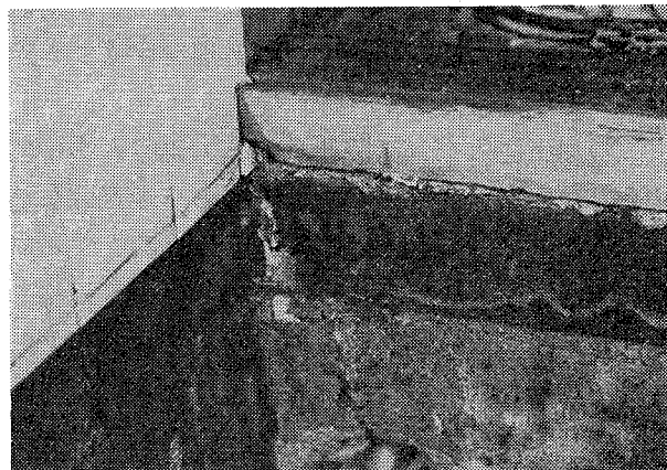
写真12 加圧注入材にもシロアリの被害 本写真例の土台の内部は完全に食害
