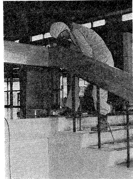
蟻道もみえる鉄筋のシロアリ施工
