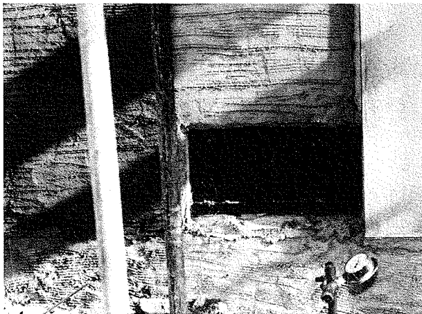
写真2 布基礎に設けられた大きな換気口 (三根公民館)
