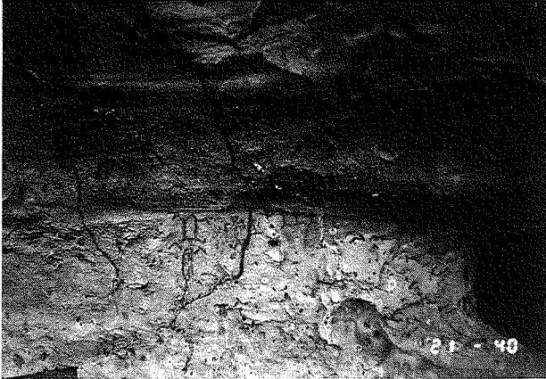
写真6 インディオ岩壁面に2本の蟻道がある
