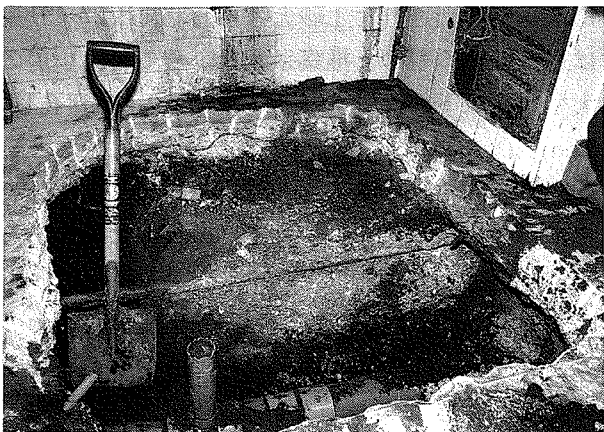
写真8 厨房のコンクリートたたき下から発見されたイエシロアリの巣（手前の一部を取り出したところ）
