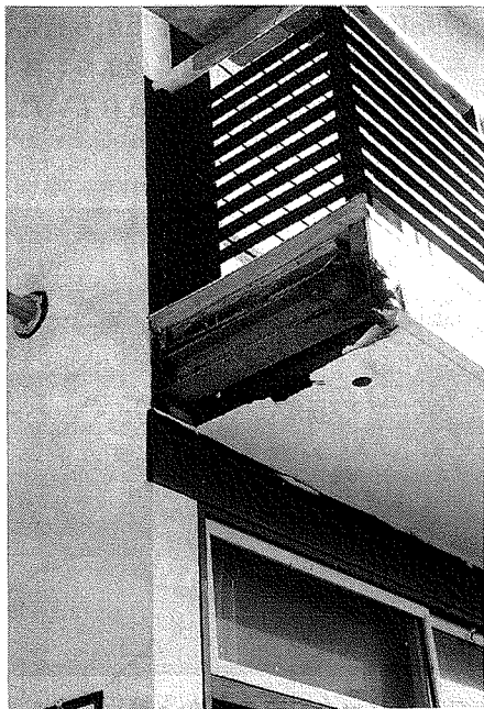
写真4 ベランダのモルタル塗装を破ったところ（内部はこのようにシロアリに加害されていた。）
