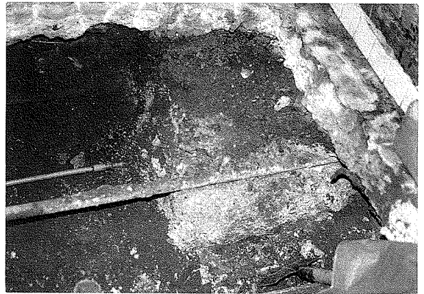
写真10 厨房のコンクリートたたき下から発見されたイエシロアリの巣の一部（このように温水パイプや水道管を抱き込んで営巣されていた。）
