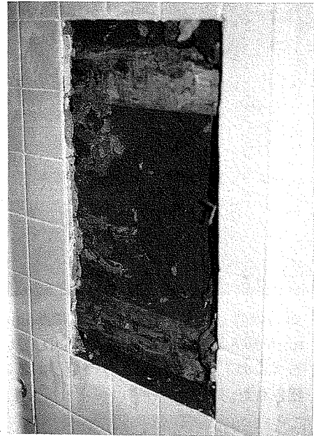
写真5 厨房のタイル壁を破ったところ（内部に大量の蟻土が運び込まれていた。この斜下方のコンクリートたたき下に巣があった。）
