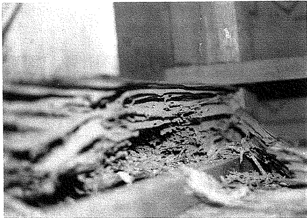
写真3 厨房前室の梁材のシロアリ被害(2)
