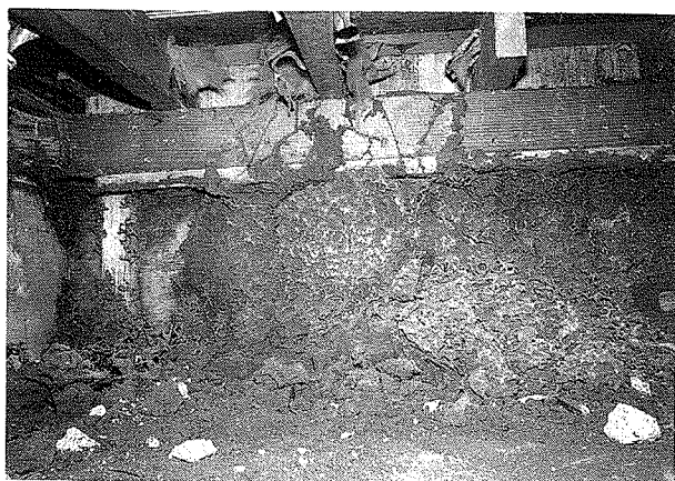
写真16 更衣室2の浴室2側の基礎コンクリートにつけられた蟻道と蟻土
