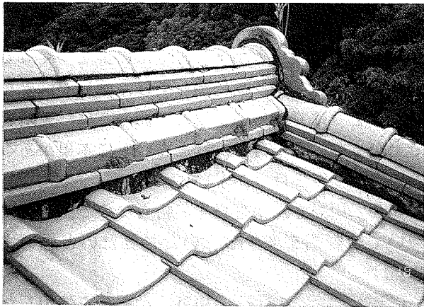
写真1 イエシロアリの蟻土や蟻道が各所に見られる釉薬瓦ぶきの屋根
