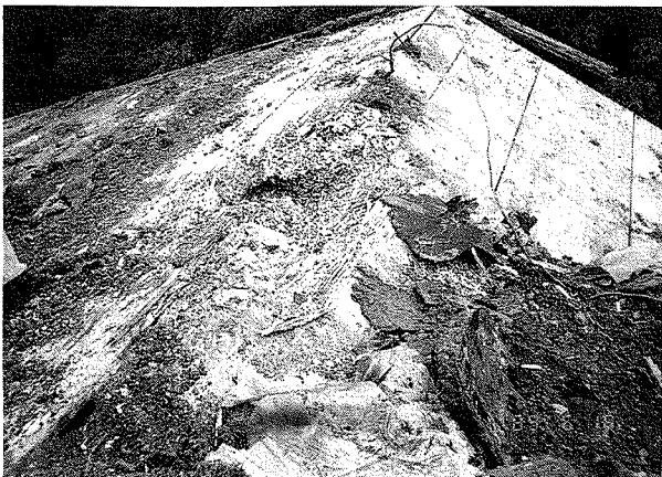
写真2 野地板と棟木部分のイエシロアリの被害（屋根瓦を取除いたところ）
