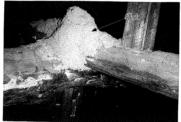
第9図 小屋組梁の巣と蟻土
