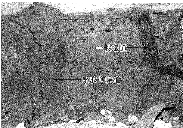
第7図 水取り蟻道と一般蟻道
