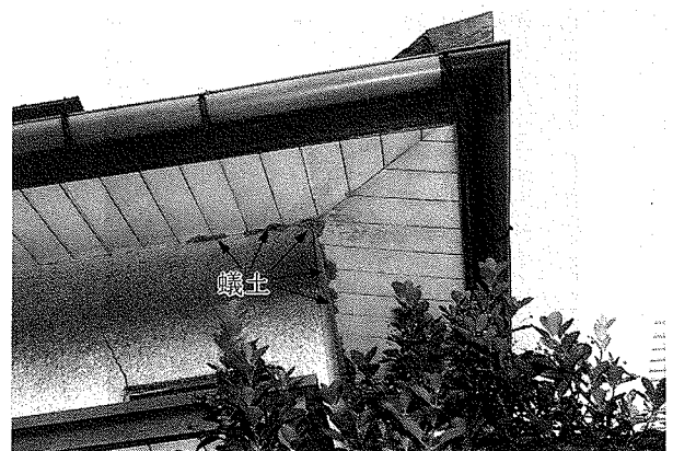
第4図 被害家屋の軒下に蟻土、蟻道が見られる
