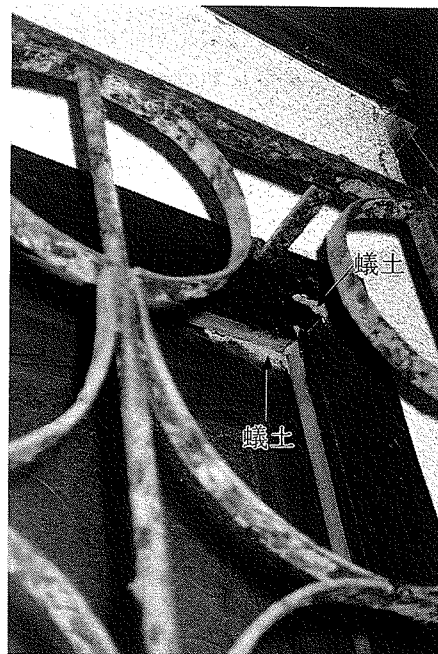
第6図 窓枠の角に蟻土と被害
