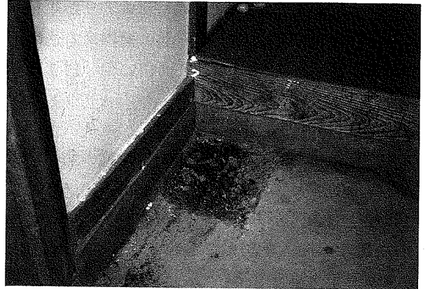
第7図 玄関コンクリート土間下の巣
