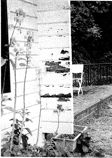
写真7 イエシロアリによるログハウスの被害
