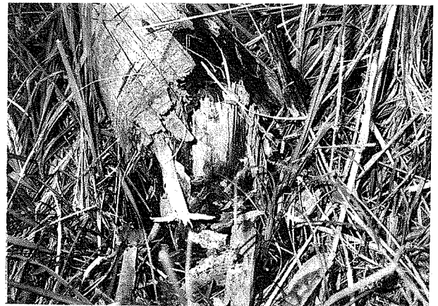
写真8 電柱の被害（この下に巣があった）
