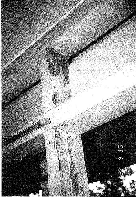
写真11 柱が加害されている
