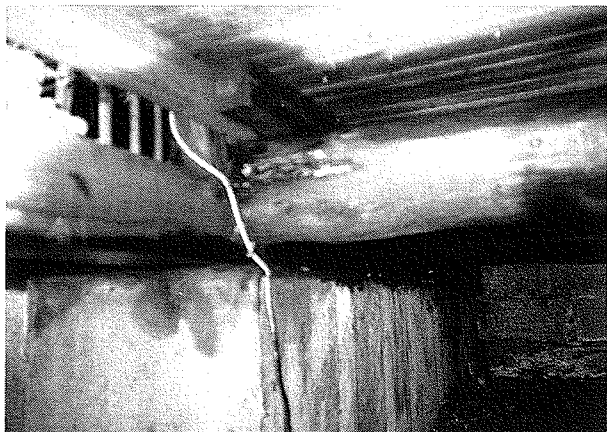
写真一3 シロアリの被害にあった床下
