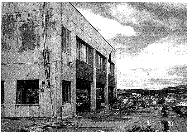
写真3 奥尻島青苗 (鉄筋コンクリート造建築物の構造躯体は被害を余り受けなかった。)
