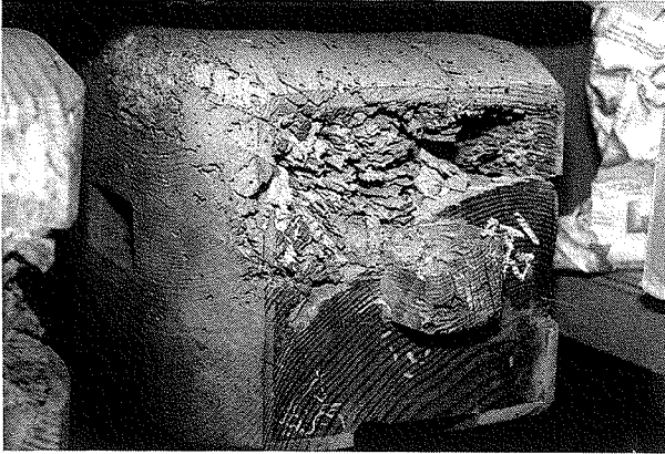
写真15 ケブカシバムシによる梁材の被害（東光寺鐘楼）
