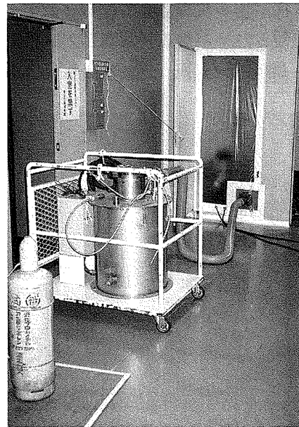
写真111 密閉燻蒸において使用中の気化機
