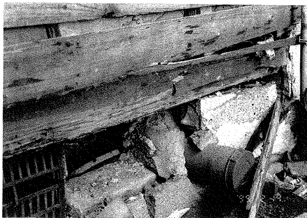
写真一4 モルタル塗大壁内部の土台の蟻害（芦屋市津知町8）
