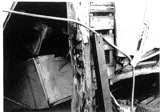
写真一2 モルタル塗大壁内部の柱の腐朽 (芦屋市公光町2)
