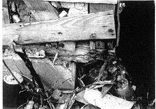
写真一1 真壁式住宅土台および柱基部の腐朽と蟻害 (西宮市仁川町3丁目14)
