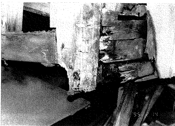
写真一5 モルタル塗大壁内部の土台、柱、下地板の腐朽と蟻害（神戸市東灘区本山中町1丁目12）
