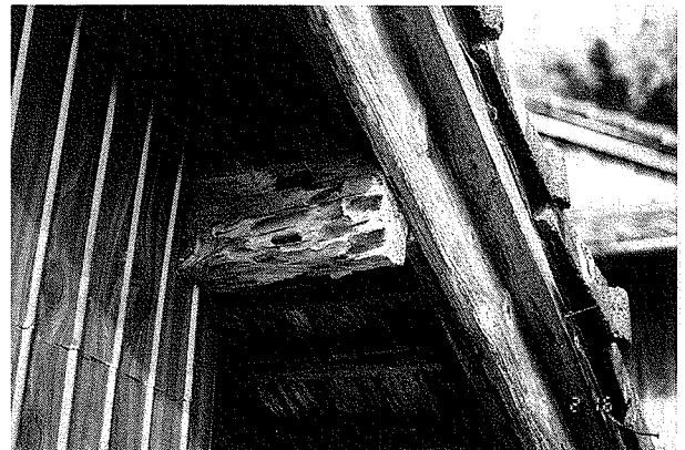
アメリカカンザイシロアリによる桁・梁の被害
