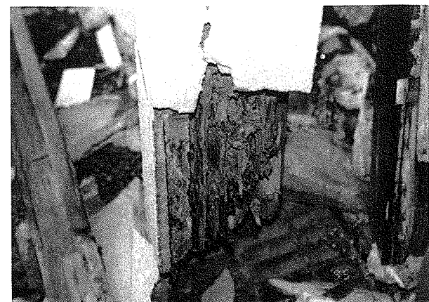
写真一3 モルタル塗大壁内部の柱の腐朽と蟻害 (芦屋市川西町3)
