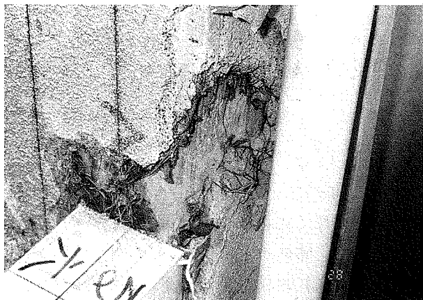
写真1 オオナガシバムシによるモルタル塗壁内部の被害（末松氏提供）
