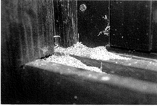
写真23 サッシレール部の虫糞
