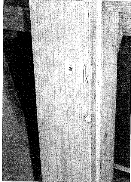
写真19 2階西側和室6畳の西側柱のシロアリ被害 (B氏宅)
