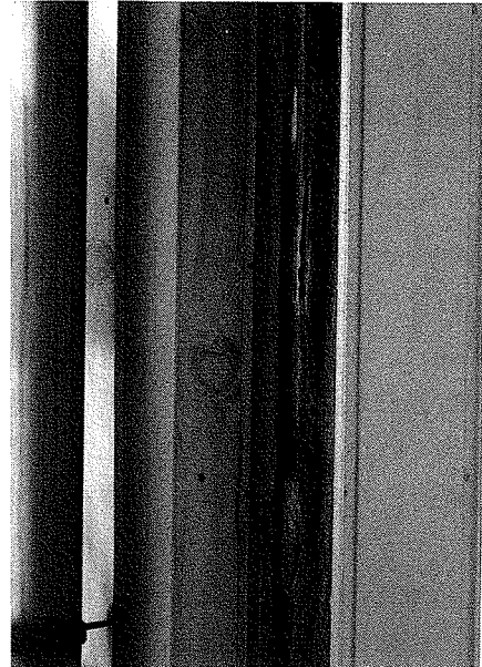
写真24 建物南東部の外角柱のシロアリ被害(C氏宅)
