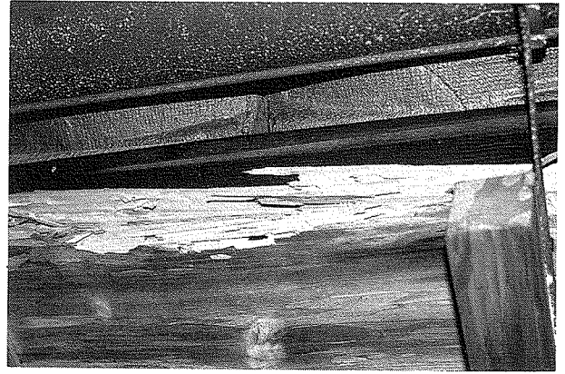
写真19 軒の被害①
