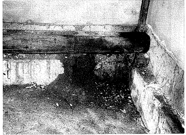
写真3 基礎コンクリートにつくられたイエシロアリの蟻道(蟻道の幅は23cm以上)(写真:山野)
