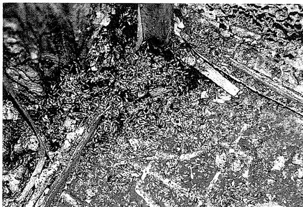
写真12 トイレ柱根元のシロアリの死骸の山
