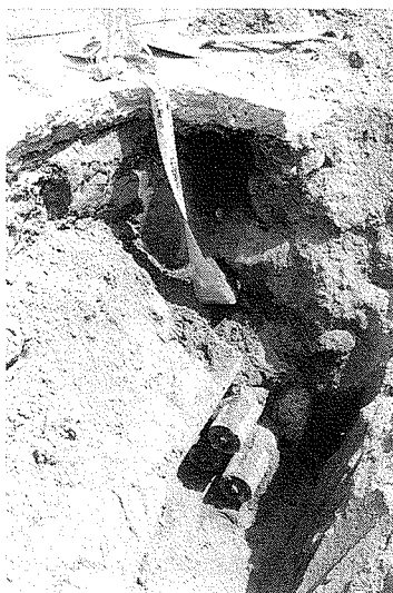
写真3 地下送電線まわりの巣
