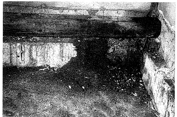
写真42 木造建築物の基礎コンクリートにつくられたイエシロアリの蟻道（蟻道幅23cm以上）
