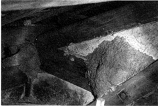
写真36 木造建築物の小屋組部につくられたイエシロアリの分巢（右）と部材の接合部に盛り付けられた蟻土（左）
