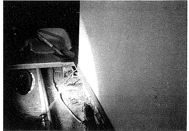
写真2 写真1の延長線上の大引の被害
